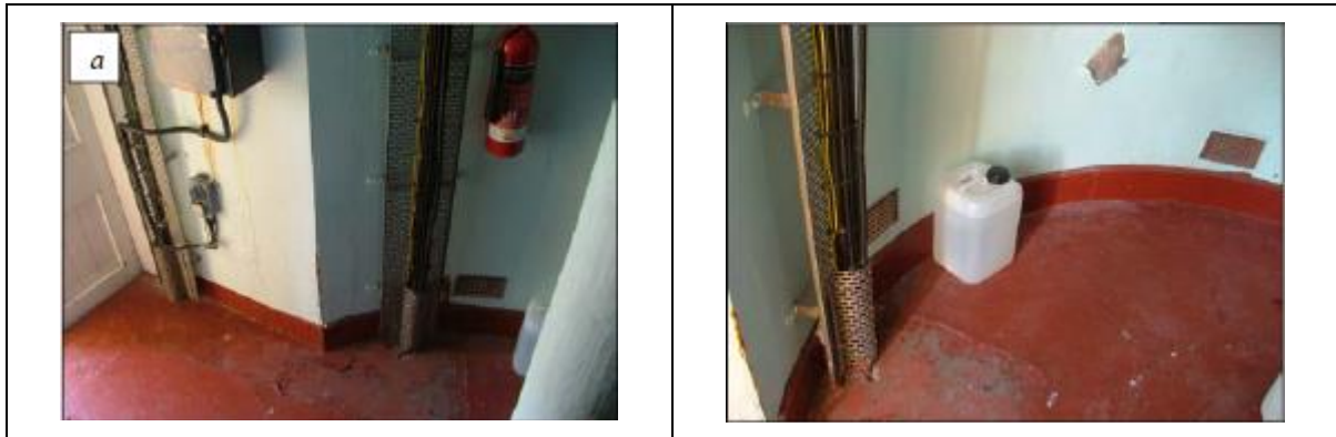
Малюнок 28: (а) Кородовані кутові пристосування, луплення фарби підлоги та плями, спричинені корозією, на стінах; (б) фарба, що лупиться, та пошкоджена штукатурка.
