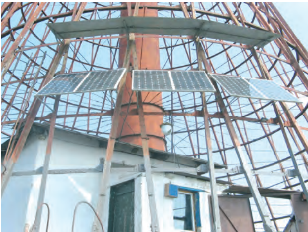
Так виглядає обладнання Станіслав-Адзигольських маяків
