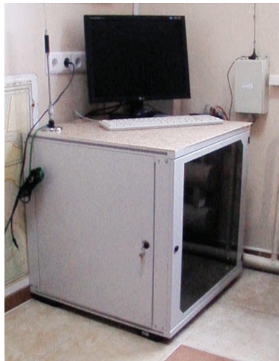
Обладнання базової станції АІС
